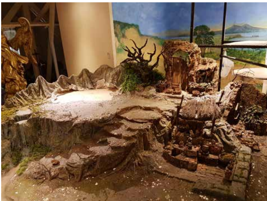
Fig. 205. Cenário em processo de reconstrução e restauração do piso, 23 de maio de 2019.
